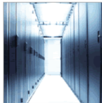
国内CTCデータセンターからのサービス提供
